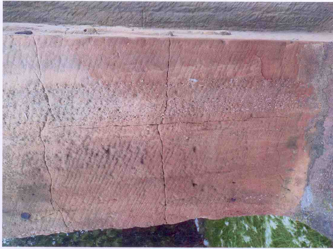
Detail poškození prasklinami na podstavci.
