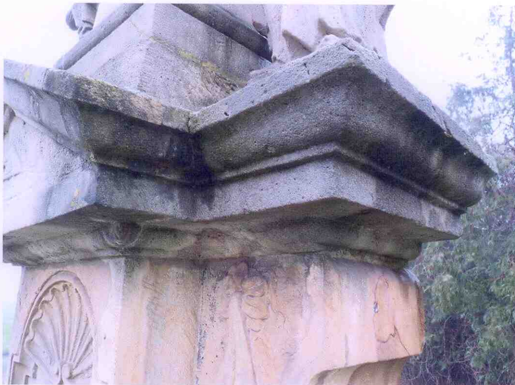
Krycí římsa poškozena tmavými depozity.
