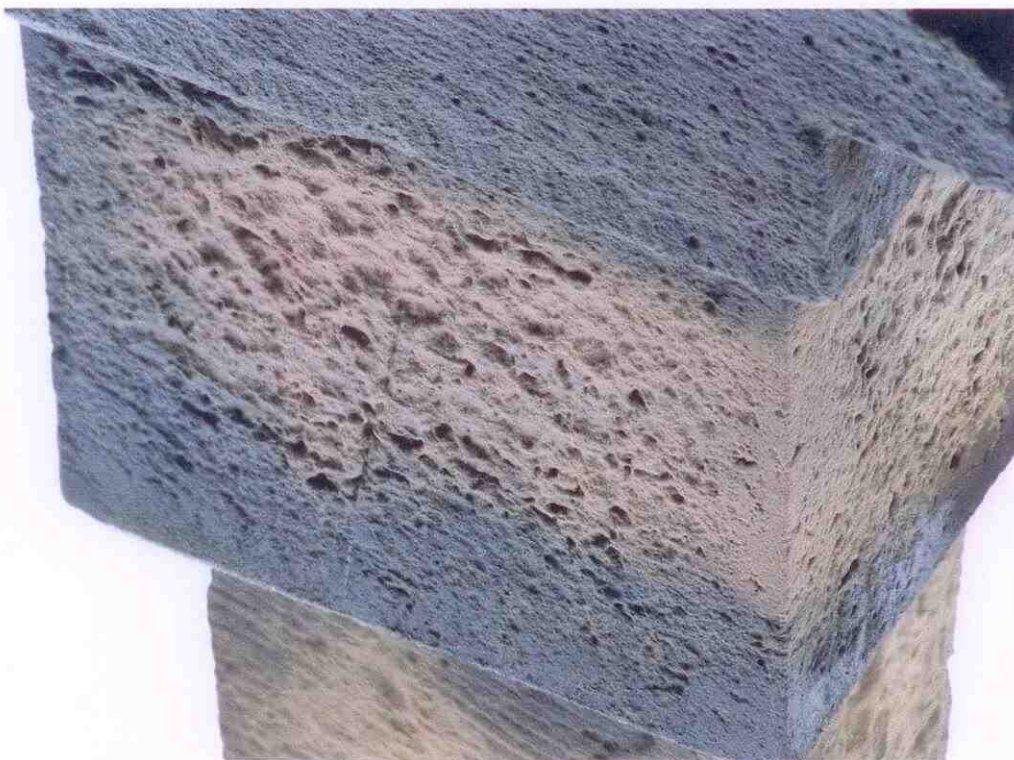
Detail korodovaného kamene na patě kříže.
