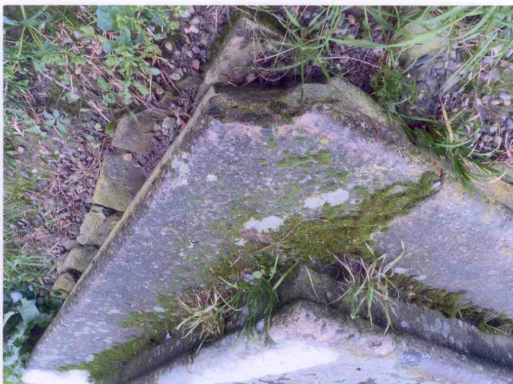
Poškozený základový schodový stúpen.
